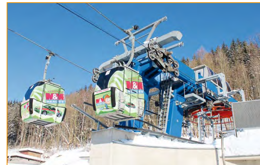
Dolní poháněcí stanice
